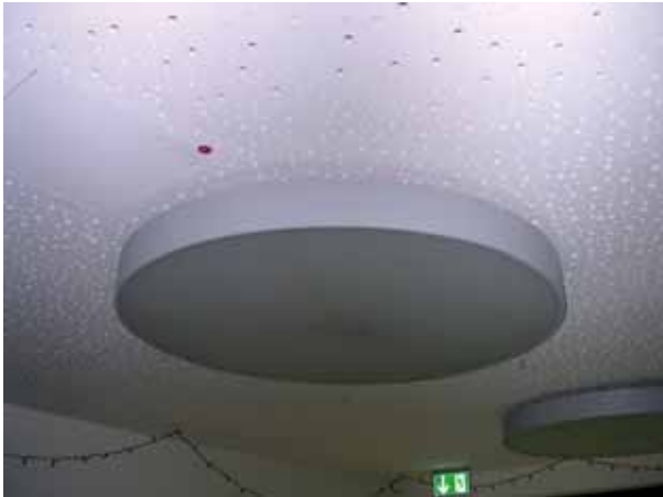
Raumakustische Decke mit Leuchtkörpern
