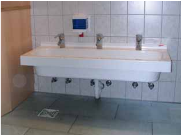
Bodenablauf unter einer Waschrinne
