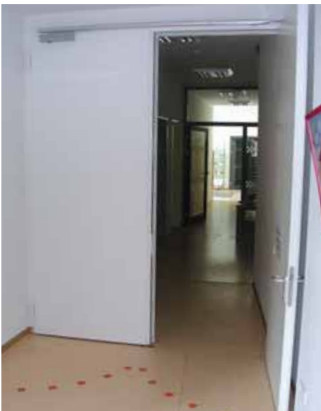
Brandschutztür mit Selbstschließfunktion
