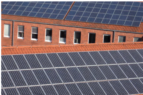
Photovoltaik-Anlage auf den städtischen Gebäuden an der Brinckmannstraße
