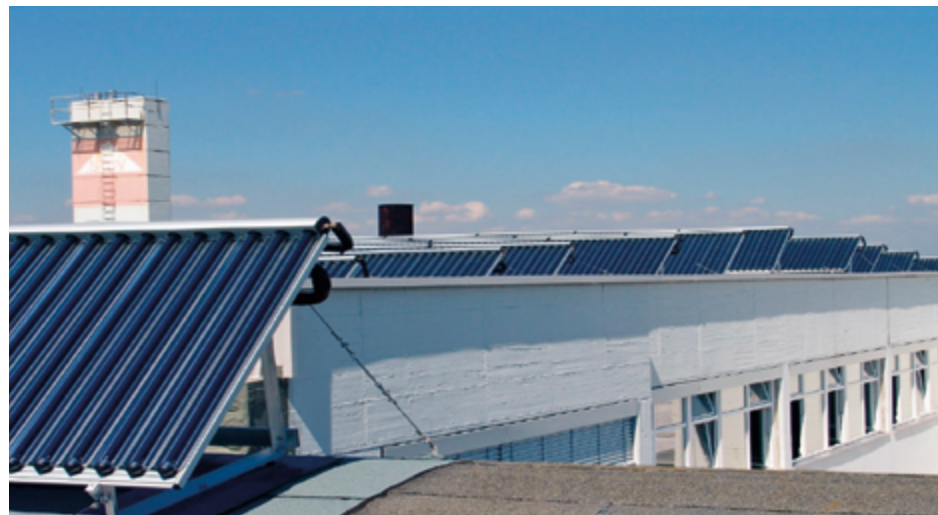
Kollektorfeld zur Bereitstellung solarer Prozesswärme
