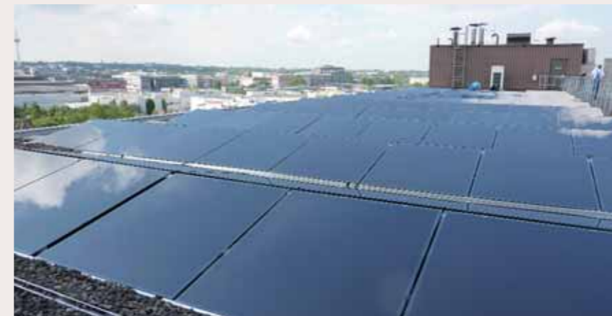
Universität Duisburg-Essen: Photovoltaikanlage
