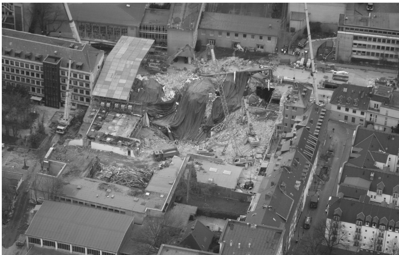
Luftaufnahme der Unglücksstelle an der Severinstraße. Foto: Stadt Köln
