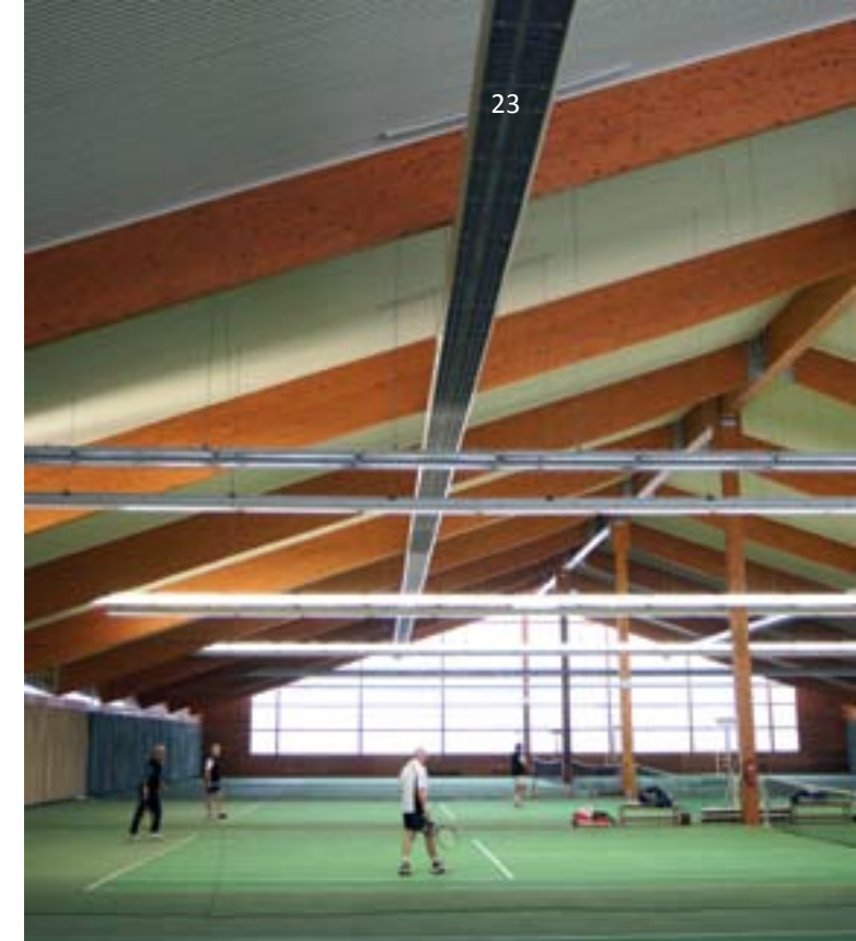
5-Feldtennishalle mit neuer Strahlungsheizung an der Decke
