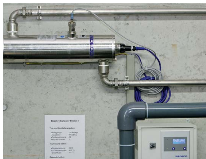
Bild 15.2: UV-Versuchsmodul Typ Wedeco A4 in der Pilotanlage Echthausen Fig. 15.2: UV trial module type Wedeco A4 in the pilot facility Echthausen
