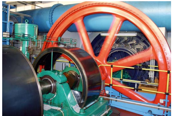
Bild 14.2: Schwungrad und Pleuellager einer Kolbenpumpe, Baujahr 1922 Fig. 14.2: Flywheel and main bearing of a piston pump, constructed in 1922
