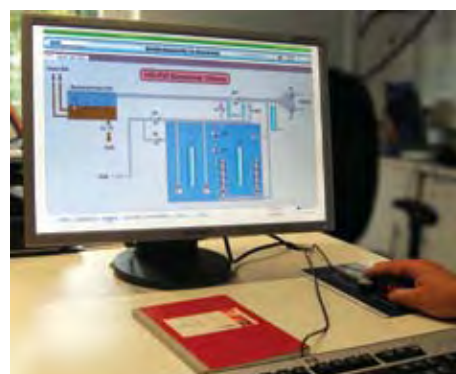
Betriebszentrale PW Kapellenstr.
