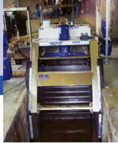
neuer Rechen KW Ratingen
