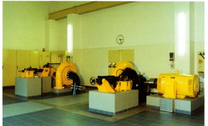
Kraftwerk der LLK GmbH
