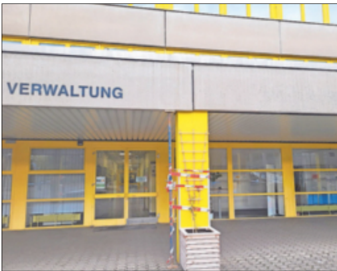
Damit die Betonplatten in der Front des Pascal-Gymnasiums nicht wie „faule Zähne“ ausfallen, werden sie mit zusätzlichen Stützen abgesichert.
