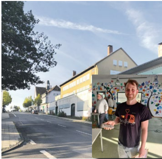
Inzwischen wird die Situation rund um das alte Möbelhaus gefährlich. Colin Cyrus präsentierte in der BV-Sitzung heruntergefallenen Putz.
