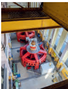
Das Wasserkraftwerk am Stauwehr des Hengsteysees (oben: Außenaufnahme, links: Blick ins Krafthaus) wurde bereits beim Bau des Sees in den 1920er Jahren errichtet.
