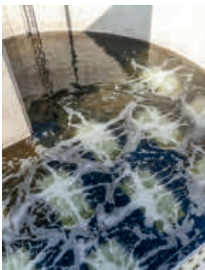
Neue Belüfterelemente erhielt die Kläranlage Bochum-Ölbachtal im Zuge einer umfassenden Optimierung vor einigen Jahren. Das Ergebnis: bessere Ablaufwerte und weniger Stromverbrauch.
