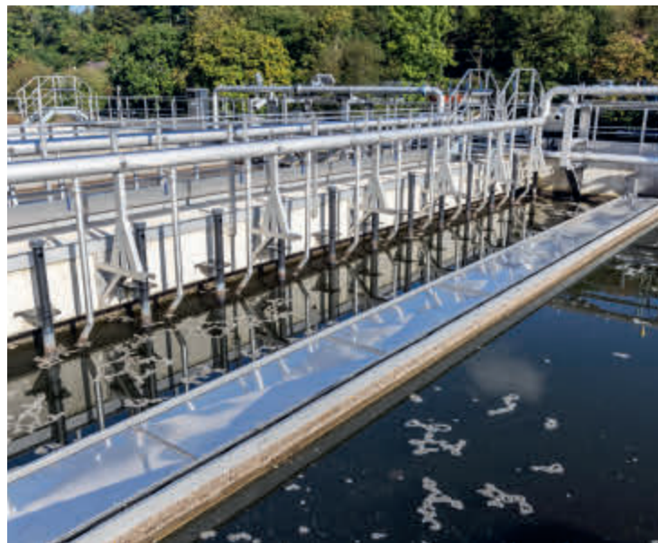
Die Kläranlage Altena arbeitet als erste Anlage deutschlandweit nach dem innovativen Reinigungsverfahren, das im Berichtsjahr einen wichtigen Leistungstest bestanden hat.
