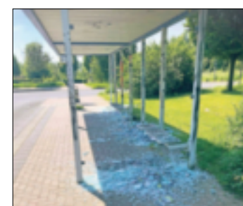
Zerstörte Wartehallen am Schulzentrum. Foto: Stadt Jüchen
