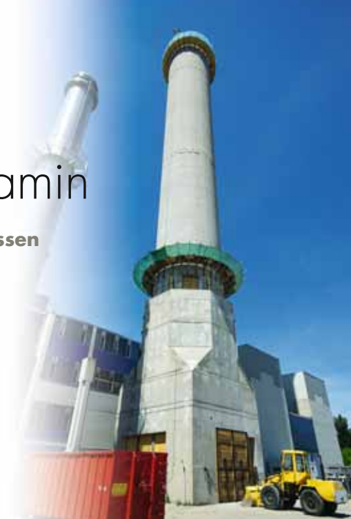
Beim Start der Arbeiten am 2. Juni ragte der Schornstein noch 84 Meter in den Himmel über Aachen empor. Foto: B. Klass
