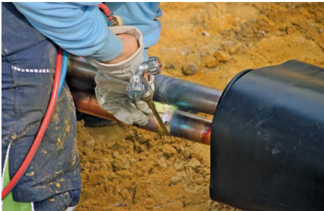
Fernwärme spielt in den Städten und Gemeinden eine immer größere Rolle
