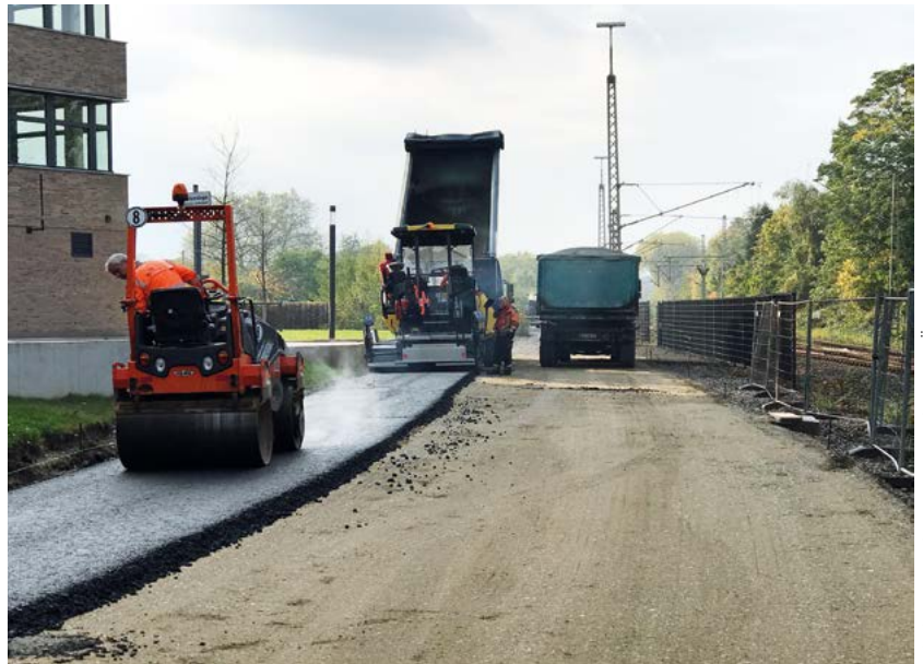
Beim Bau des Rad-schnellwegs „RS 1“ in Mülheim an der Ruhr wurden Schlackebaustoffe verwendet
