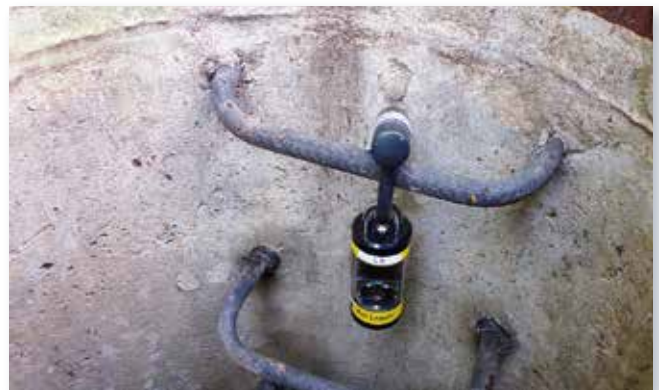
H_2S -Messgerät im Kanalschacht
