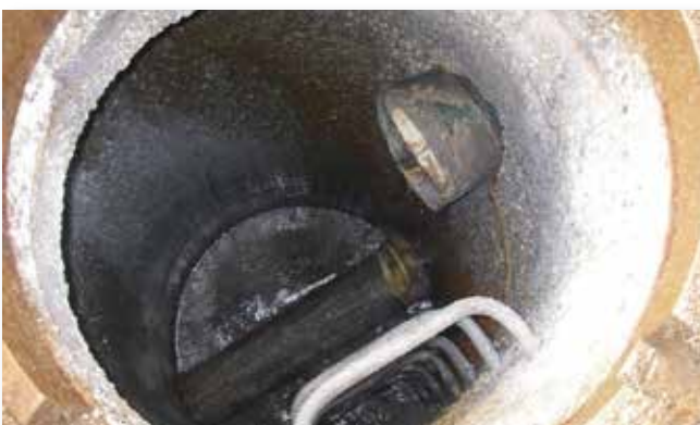
Korrosionen in Kanalschacht
