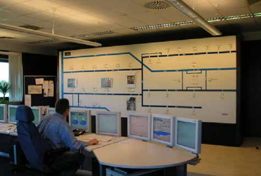
Fernsteuerzentrale Wasserversorgung Datteln. Foto: RIK/Budde
