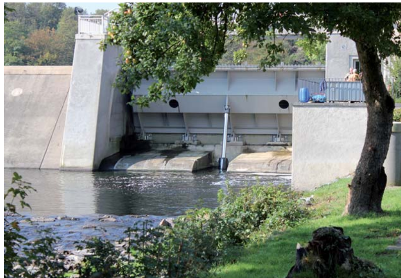
Fischbauchklappe am Stausee Beyenburg
