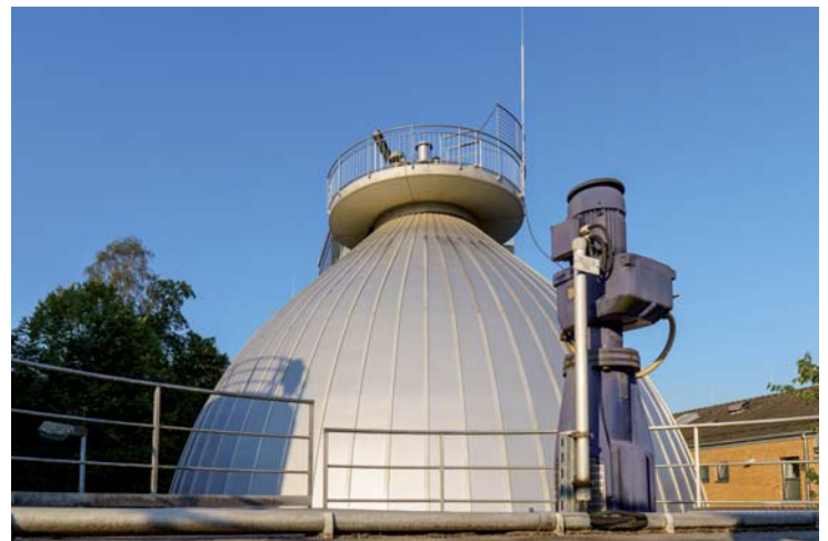
Kläranlage Hückeswagen, Faulbehälter
