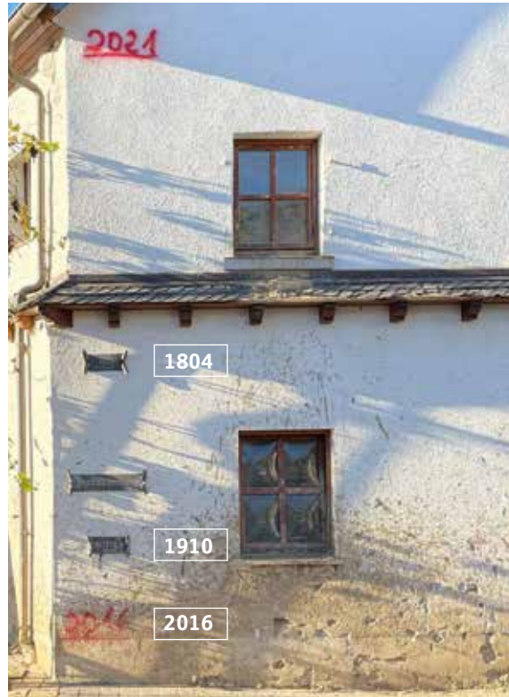
Die auf diesem Wohnhaus in Dernau im Ahrtal aufgetragenen Pegelstände historischer Überschwemmungen führen das komplette Ausmaß des Hochwassers im Juli nochmals eindrücklich vor Augen. Lokale Aufstauereffekte hatten hier zu extremen Wasserständen geführt. (Quelle: Artur Kubik)
