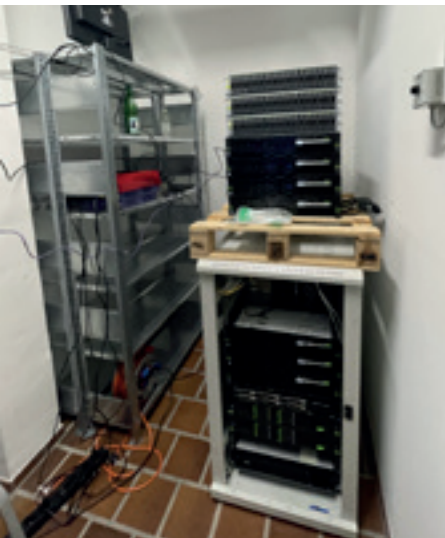
Der Hauptserver der Diakonie wurde bis tief in die Nacht in der Geschäftsstelle auf der Venloer Straße provisorisch wieder aufgebaut.
