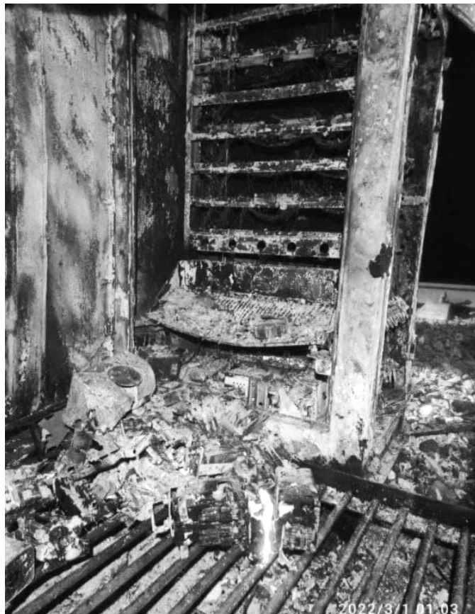
Abb. 1: Zerstörte Relaisanlage der belarussischen Bahn.
