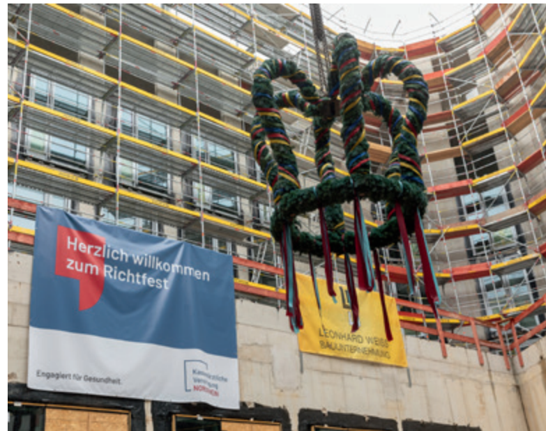
Ein Zeichen guten Gelingens: Trotz stürmischen Wetters konnte am 20. Mai der traditionelle Richtkranz am Butzweilerhof in Köln aufgehängt werden.
