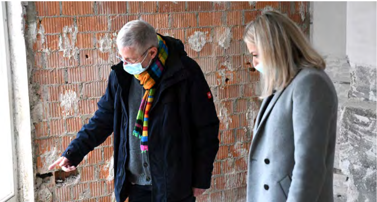
Ein allgemeines Bild der Verwüstung: Unzählige Praxen in Nordrhein sind infolge der Flutschäden stark sanierungsbedürftig, in nicht wenigen Fällen hob das Wasser die Fenster aus den Angeln.
