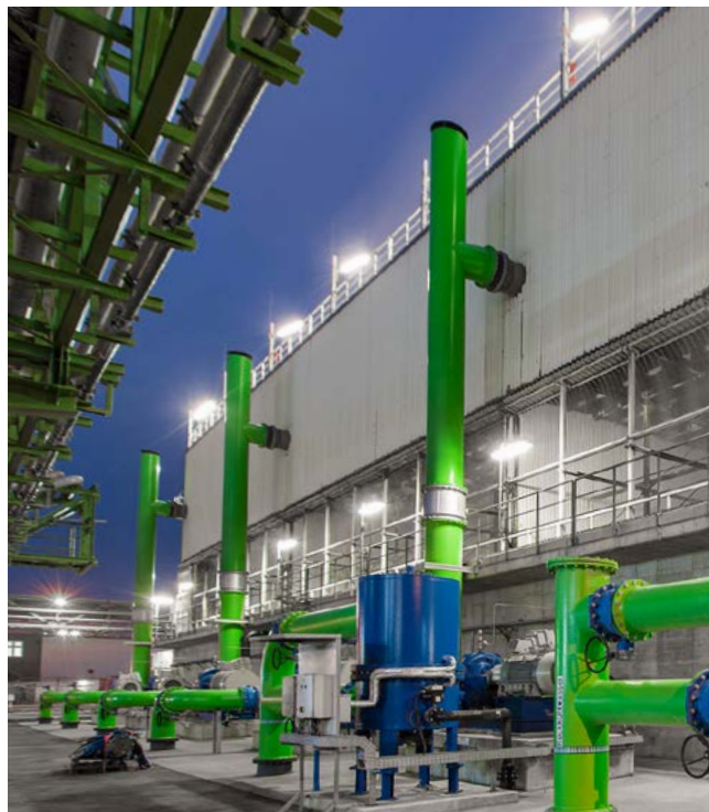
Wesseling: Erwärmtes Kühlwasser wird in der Rückkühlanlage, die aus glasfaserverstärktem Kunststoff besteht, heruntergekühlt und zum Teil wieder in den Kühlkreislauf zurückgeführt.
