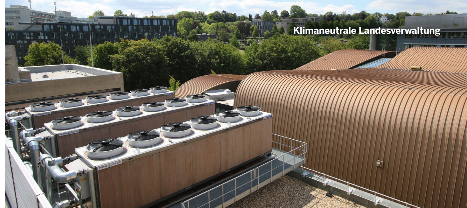
Auch neue Technik wie diese hocheffizienten Kühlwerke leistet ihren Beitrag zur klimaneutralen Landesverwaltung.
