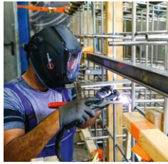
Bis die Sphère Trames in neuem Glanz erstrahlt, ist noch einiges zu tun.
