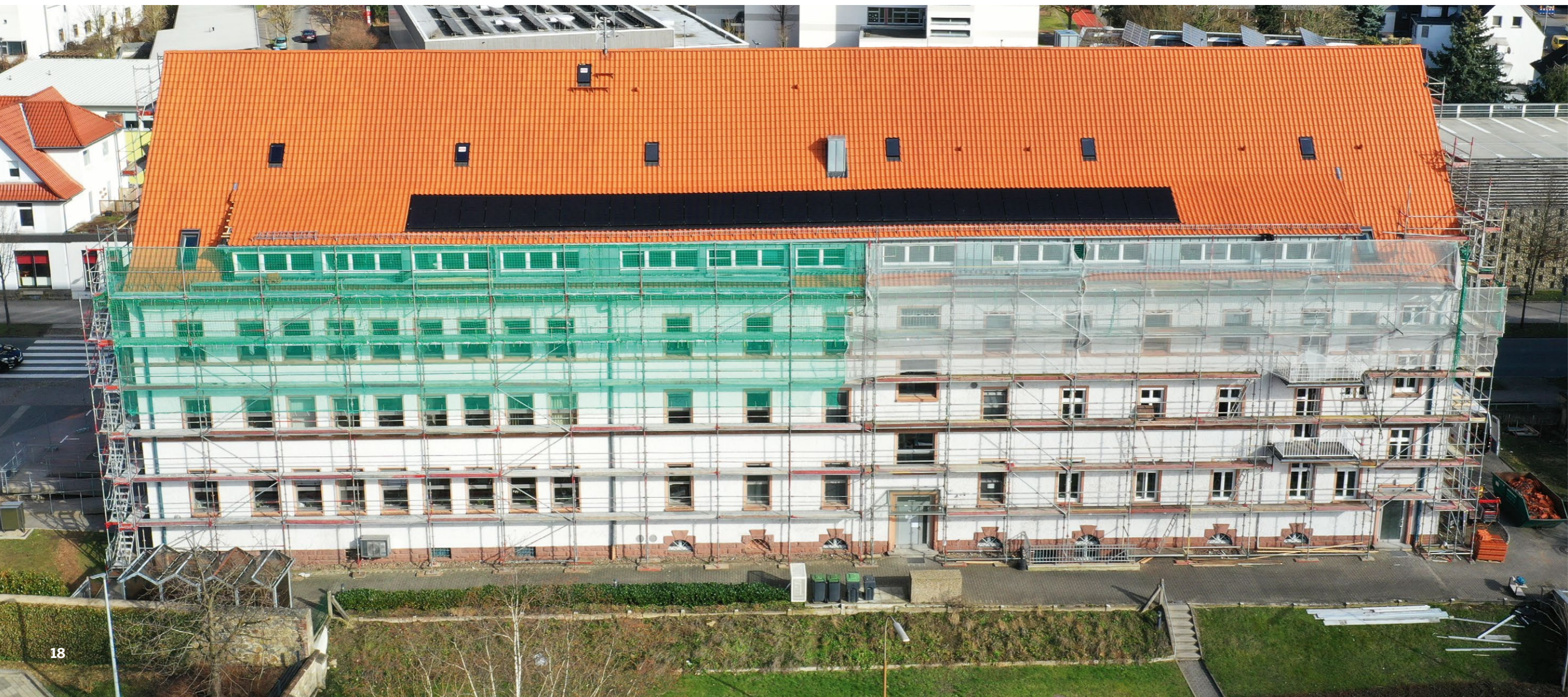
Wie ein schwarzes Band und von unten fast unsichtbar erstrecken sich die 31 monokristallinen Photovoltaik-Module über das Dach des denkmalgeschützten Finanzamtes Lemgo. Sie liegen nicht auf den Dachpfannen auf, sondern sind bündig in die Dacheindeckung integriert.
