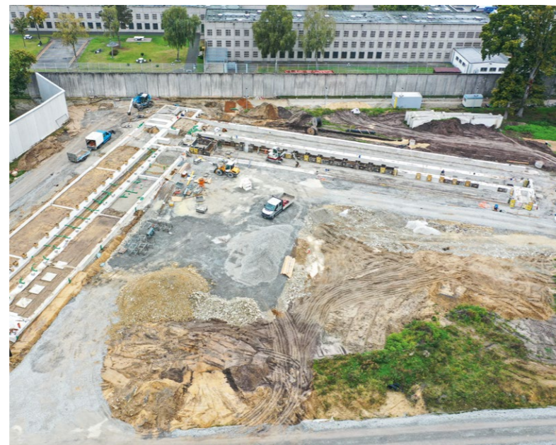
Die Baustelle für das neue Hafthaus: Per Kran werden die einzelnen Module auf das vorbereitete Fundament gehoben.
