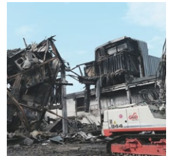
2016 hat ein Großbrand die alte Maschinenhalle fast vollständig zerstört.
