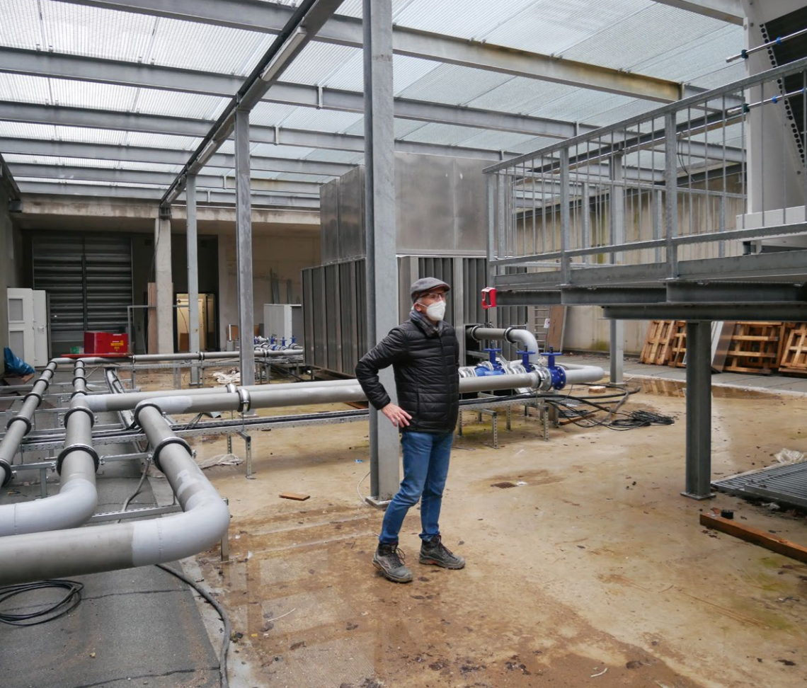
Nachhaltigkeit spielt auch im Bundesbau eine wichtige Rolle: Große Blockheizkraftwerke dienen zur Rückkühlung der Technik. Mit der gewonnenen Wärme wird das Gebäude beheizt.
