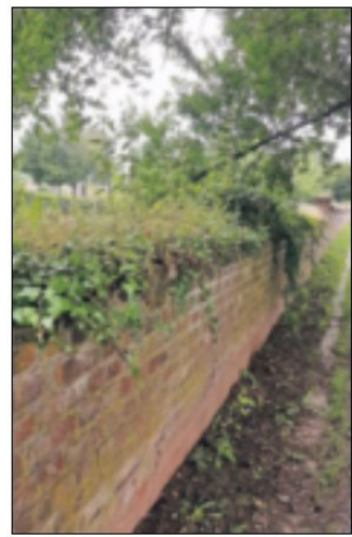
Die Wevelinghovens Friedhofsmauer ist Überwucherung und Verfall übergeben...
