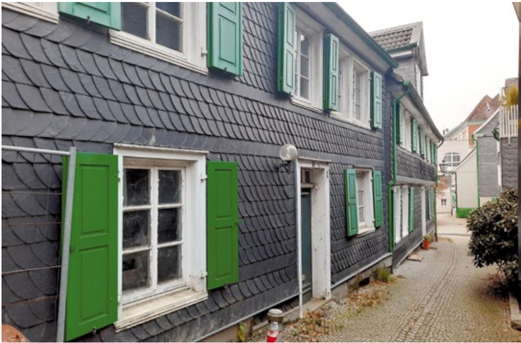
Das Haus Munsterplatz 21 ist ein Beispiel für ein sanierungsbedürftiges Objekt im Eigentum der Stadt.
