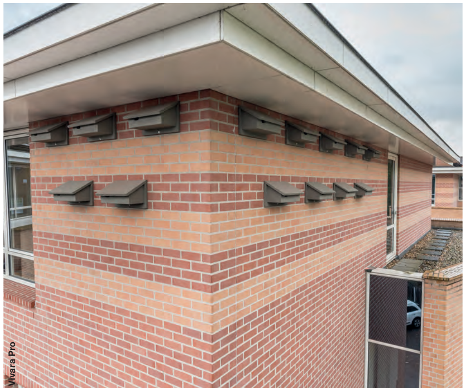
Für Artenschutzmaßnahmen am Haus gibt es heutzutage viele Lösungen und Angebote
