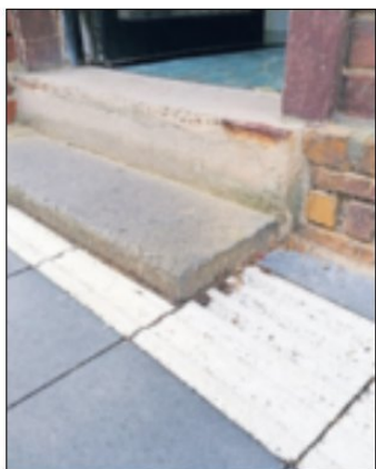
Die weißen Streifen sollen sehbehinderten Menschen Orientierung bieten – enden aber an der Eingangsstufe.
