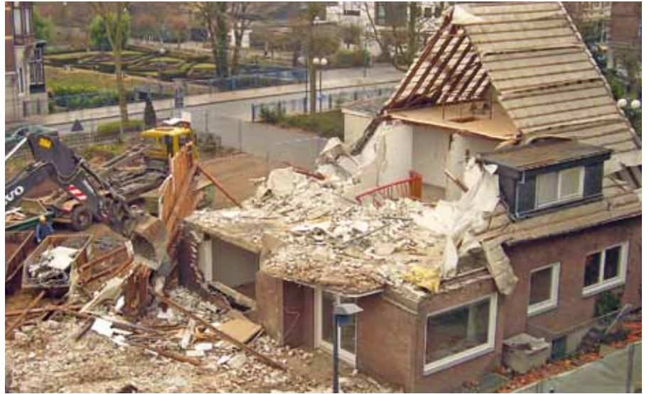
Abriss des Pfarrhauses an der Brückenstraße 6, um Platz für den Neubau eines Hauses der Diakonie zu machen
