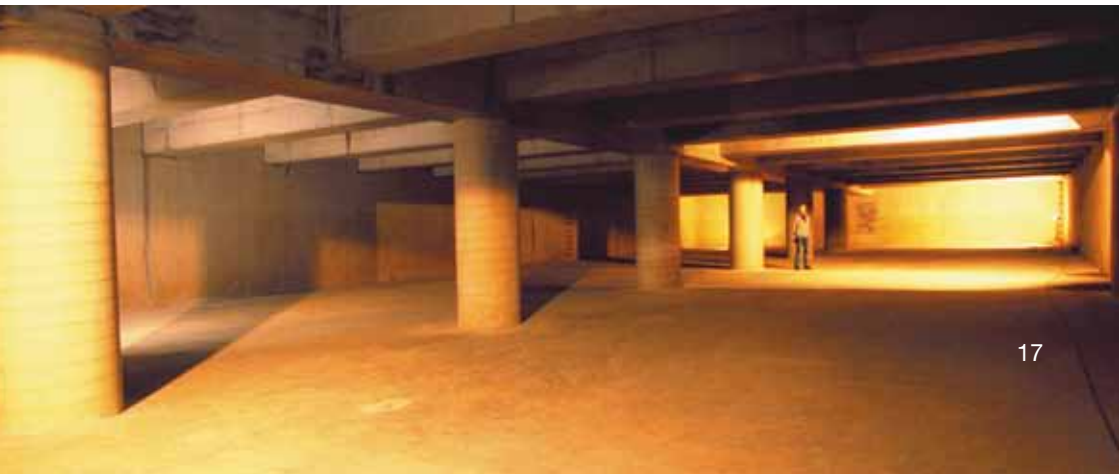
Regenüberlaufbecken am Borbecker Mühlenbach
