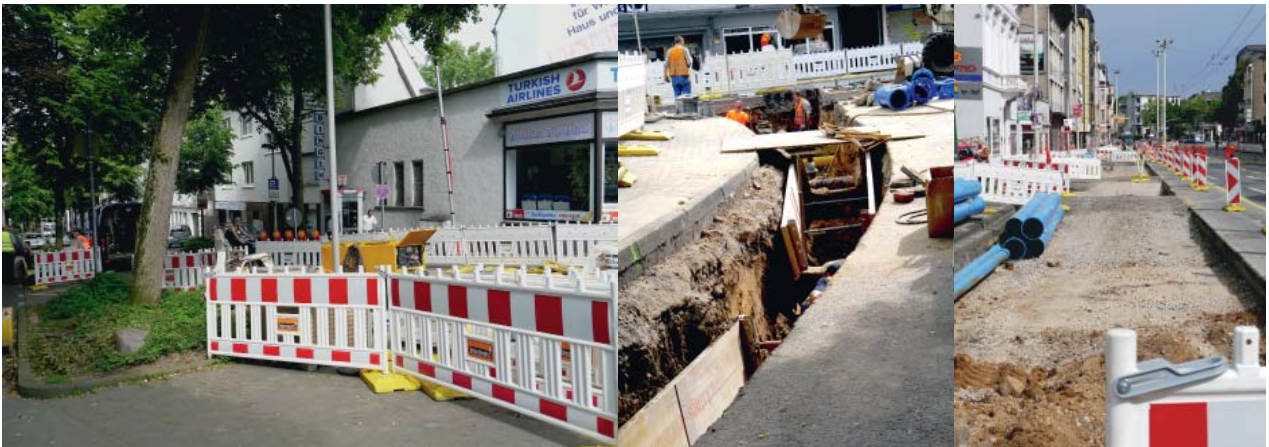
Die Zufahrt zur Augustastraße ist momentan nicht möglich, da hier im Zuge des Umbaus auch gleich die Rohrleitung neu verlegt werden (Foto links und z. v. r.). Auch auf der Konrad-Adenauer-Strasse werden neue Rohrleitungen verlegt (Foto rechts). Foto: K. Odenius
