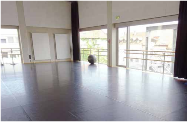
Fast optimaler Tanzboden. Lediglich die Verklebungen können Stolperstellen darstellen und müssen regelmäßig erneuert werden
