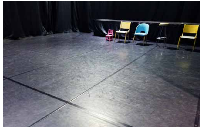
Oberflächlich in Ordnung, kein schwingender Unterboden vorhanden. Auch ein optimaler Deckbelag kann einen Tanzschwingbogen nicht ersetzen
