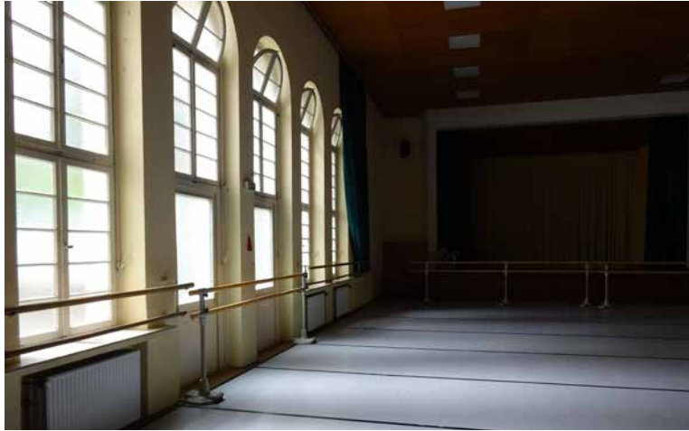
Raumklimatische Probleme durch Einfachverglasung und Position der (mobilen) Stangen
