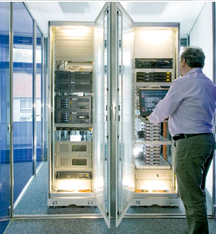
Leitwarte und Zentralrechner der Talsperrenleitzentrale des Ruhrverbands in Essen.
