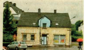
Ein wenig gerupft steht das Haus derzeit da, nachdem die Dämmung entfernt worden ist.
