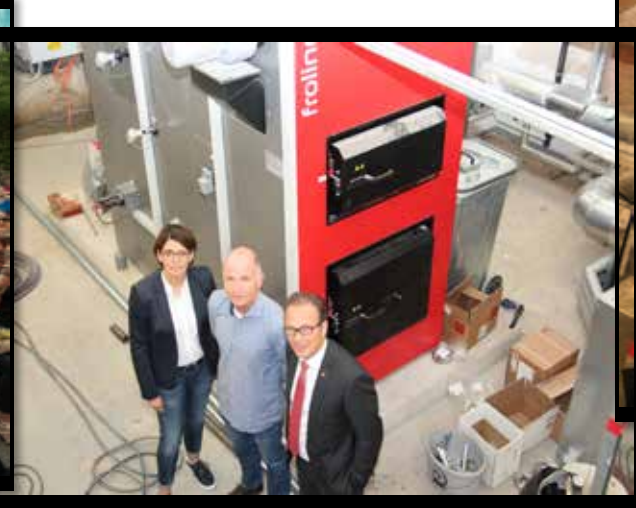
17. August: Bürgermeister Reiner Breuer schaut sich mit Andrea Schiefke vom Gebäudemanagement und Architekt Richard Wichmann die neue Heizungsanlage an
