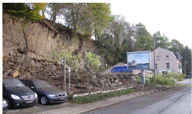
In der Nacht des 4. November 2012 ereignete sich in Essen-Byfang ein Felssturz. Ca. 500 m 3 Gestein brachen aus der Felswand. Der Schutt reichte bis auf die Nierenhofer Straße, die abgesperrt werden musste (Foto: GD NRW).
