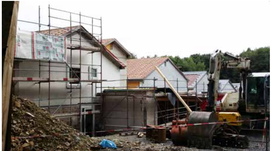
Das Gelände an der Kaisereiche Anfang August: Das Sommerfest am letzten August-Sonntag wird das letzte auf einer Baustelle sein. Das Haus wird im Frühjahr fertig gestellt und vor den Osterferien bezugsfertig sein.
