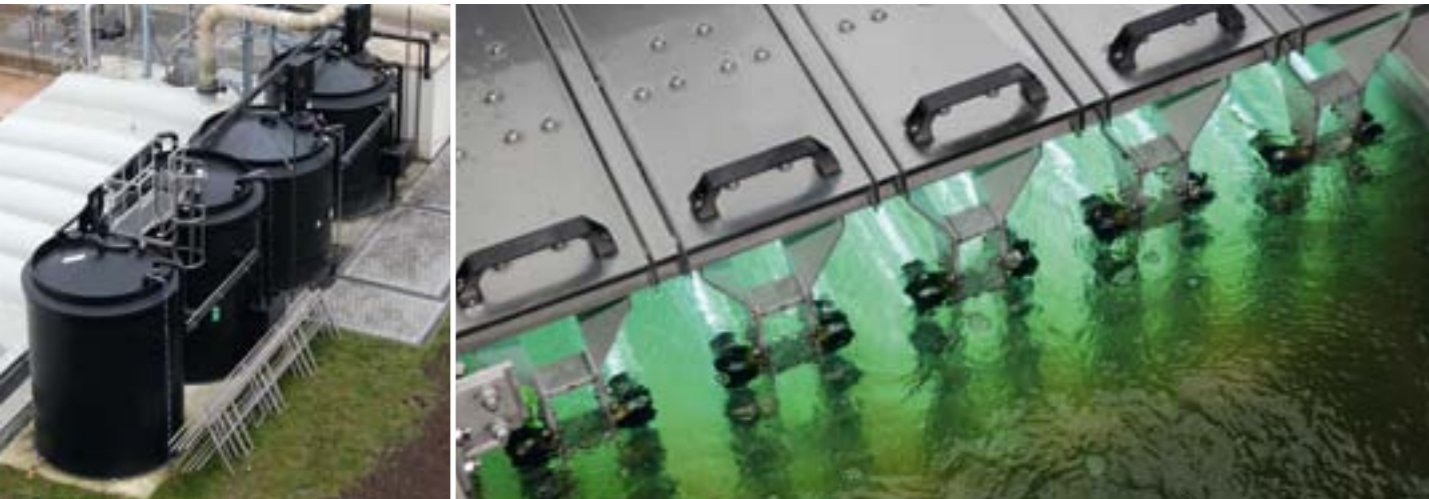
Auf der Kläranlage Warstein wurde im Sommer 2014 eine vorgeschaltete Hochlastbelebung errichtet. Die provisorische UV-Anlage wurde durch eine neue, technisch optimierte UV-Anlage ersetzt.
