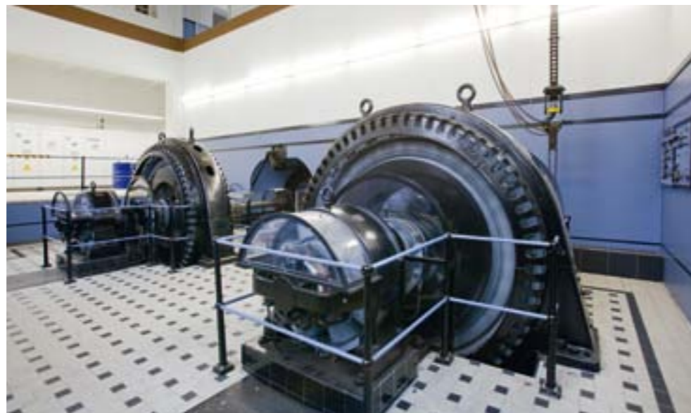
28 Maschinensätze in 16 Wasserkraftwerken gehören zum Kraftwerkspark der LLK.
