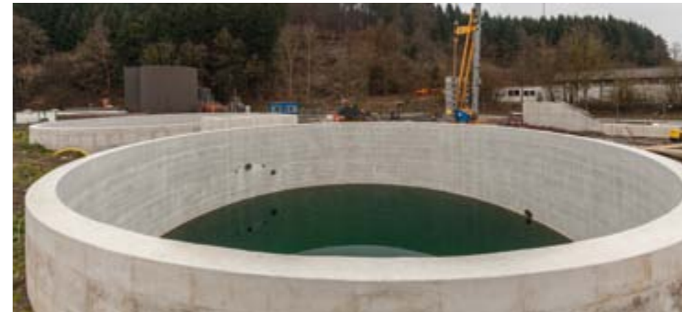
Auf der Kläranlage Eslohe begannen die Bauarbeiten zur Erweiterung und für ein neues Regenüberlaufbecken.
