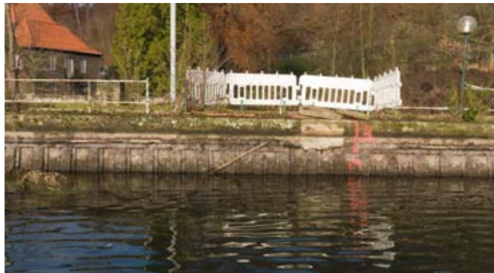
Die Spundwand, die den Damm zwischen Baldeneysee und Poldergebiet abdichtet, ist undicht.
