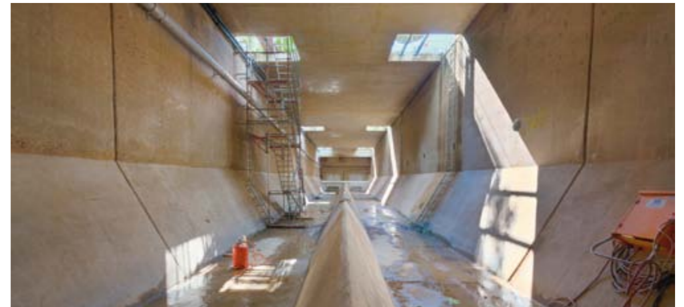
Die Arbeiten am neuen Regenüberlaufbecken Zechenweg der Kläranlage Velbert-Hespertal dauerten elf Monate.
