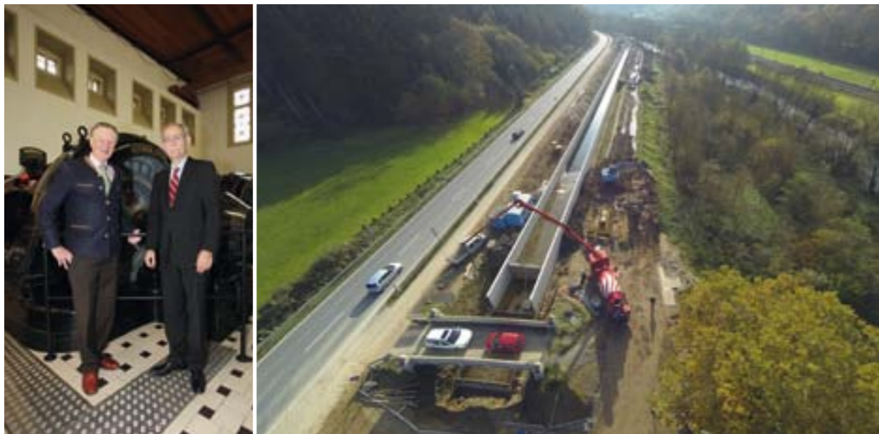
Das Laufwasserkraftwerk Bamenohl aus dem Jahr 1923 wurde im Dezember 2014 wieder in Betrieb genommen (l.). Zuvor war der Obergraben in zwei Bauabschnitten saniert und als Betongerinne ausgeführt worden (r.).
