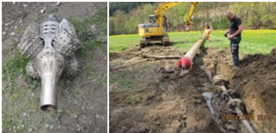
In Schmallenberg kam ein spezieller ferngesteuerter Bohrkopf zum Einsatz (l.). Die Rohrleitung (r.) wurde in bis zu acht Metern Tiefe verlegt.
