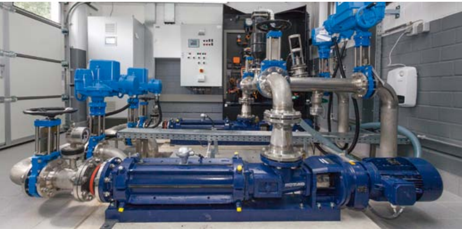
Die Kläranlagen des Ruhrverbands, wie hier in Hemer, arbeiteten auch 2014 auf einem konstant hohen Reinigungsniveau.
