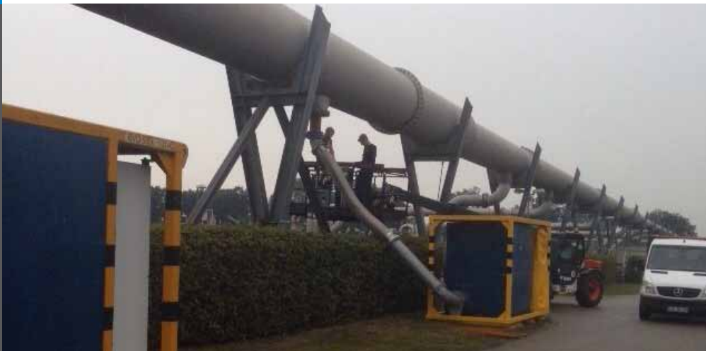
Kläranlage Mönchengladbach-Neuwerk: Die erweiterte Mietanlage im Betrieb
