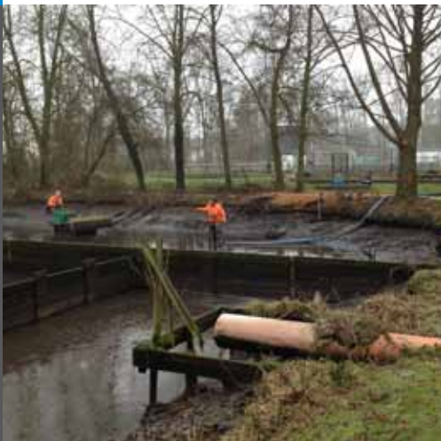
Kläranlage Wachtendonk: Teichreinigung und -wartung
