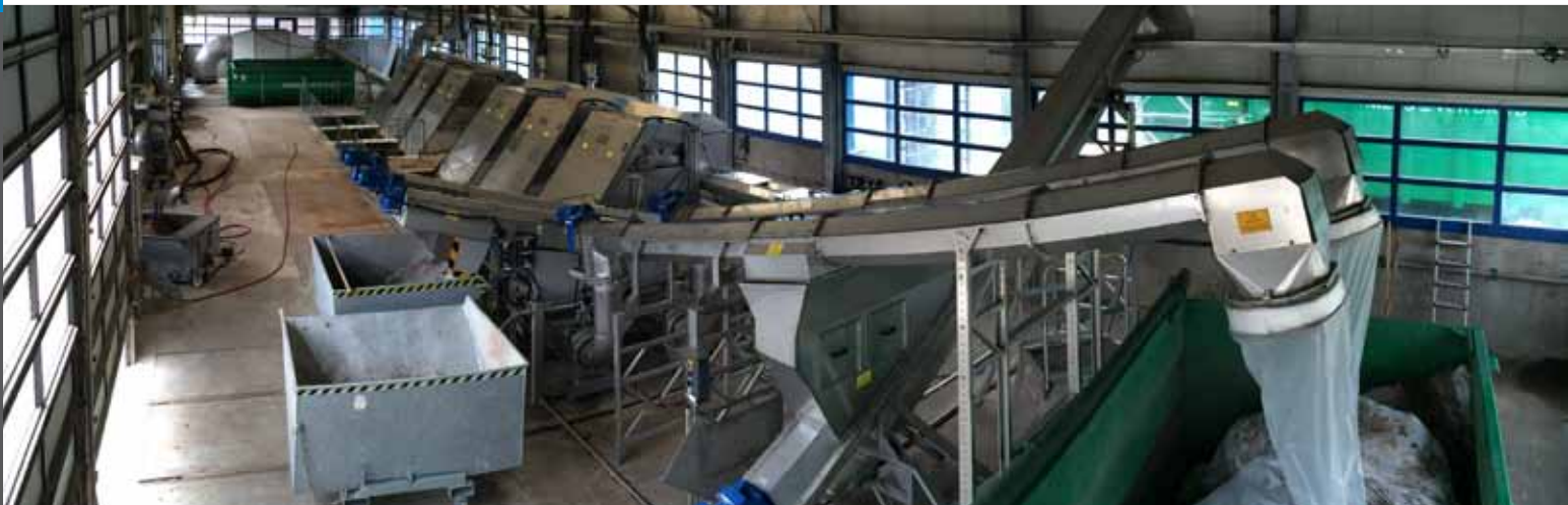
Neue Rechenanlage auf der Kläranlage Mönchengladbach-Neuwerk
