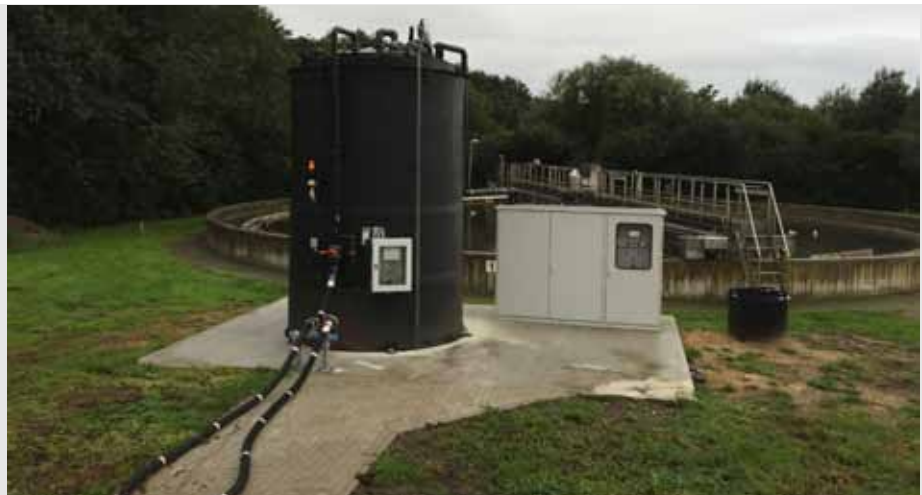
Kläranlage Goch: Neue Dosiermittelstation
