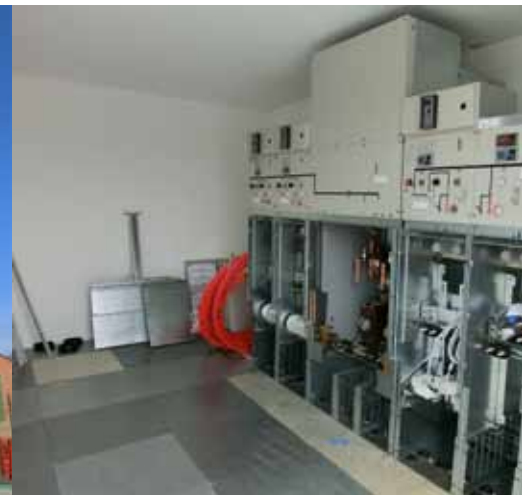
Blick in die neue Mittelspannungsschaltanlage
