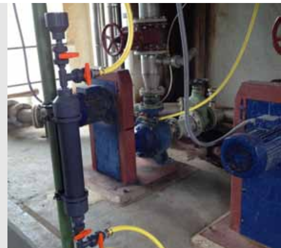
Kläranlage Dülken: Dosierschleuse in die Umwälzleitung
