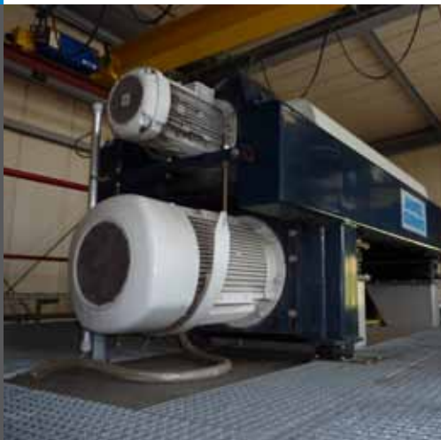
Kläranlage Geldern: Zentrifuge
