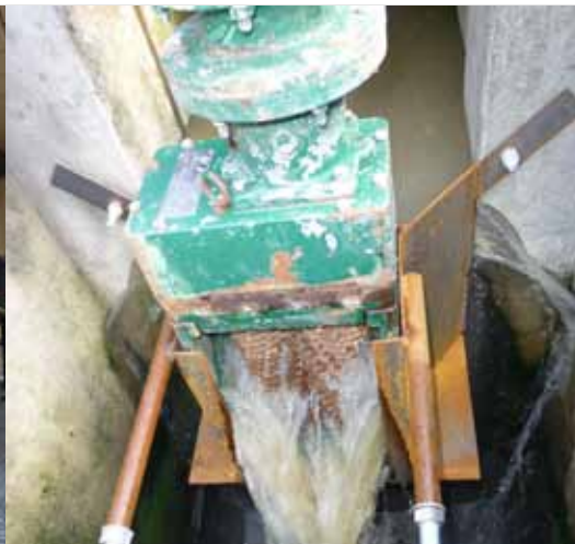
Betriebsstelle Winnekendonk - Testbetrieb mit Doppelwellenzerkleinerer
