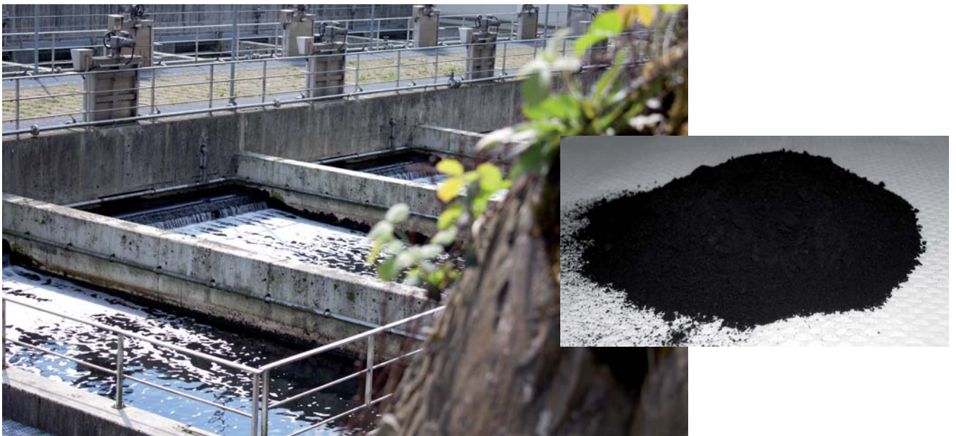
Kläranlage Buchenhofen, Flockungsfiltration, Aktivkohle
