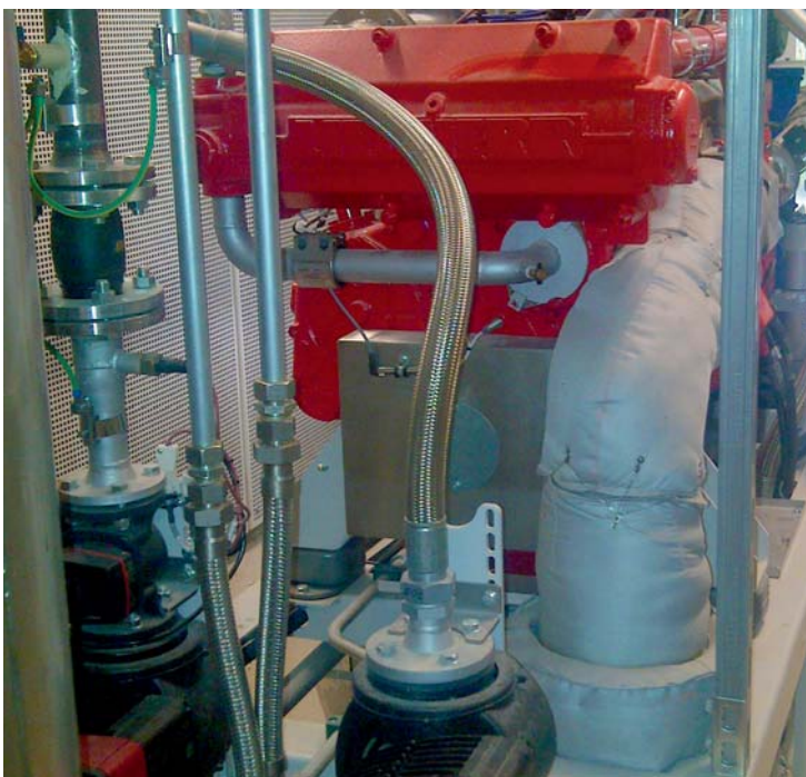
Kläranlage Burg, Blockheizkraftwerk
