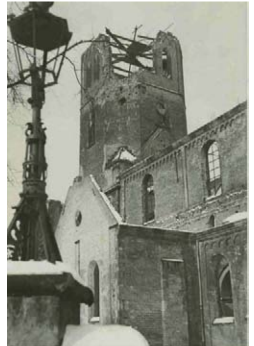
Der beschädigte Turm , noch mit dem später wieder abgetragenen obersten Geschoss.
