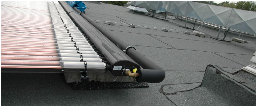
Abbildung 21: Solarthermie-Anlage auf dem Dach der Realschule Johannes-Kepler
