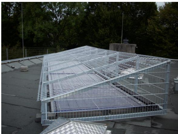
Abbildung 22: Solarthermie-Anlage auf den Sportplatz Brandenburgerstraße in Dülken
