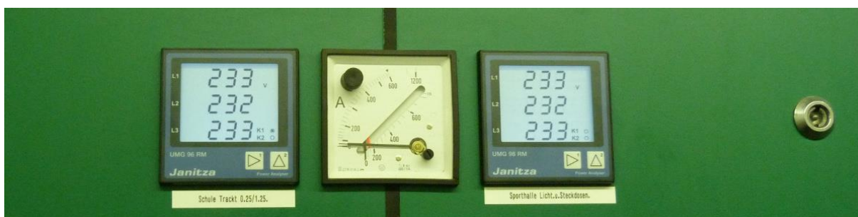
Abbildung 28: Digitale Stromzähler und altes analoges Messgerät (Mitte)
