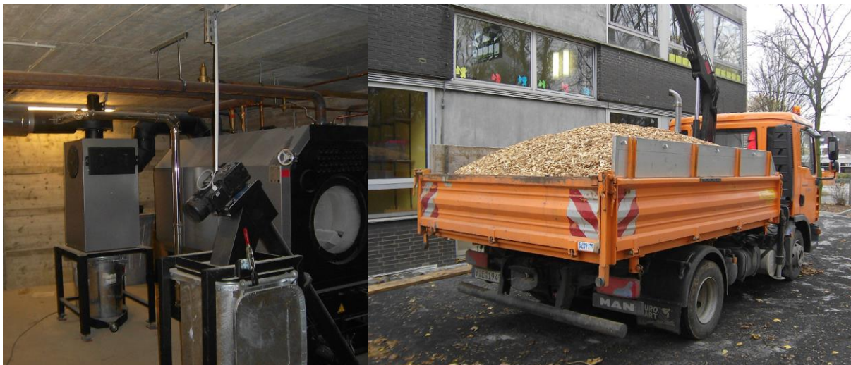
Abbildung 20: Holzhacksznitzelanlage und Anlieferung an der Gebrüder-Grimm-Grundschule
