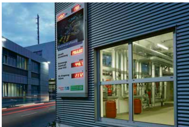
Zum Schutz des Klimas setzt der Airport unter anderem auf Blockheizkraftwerke.
