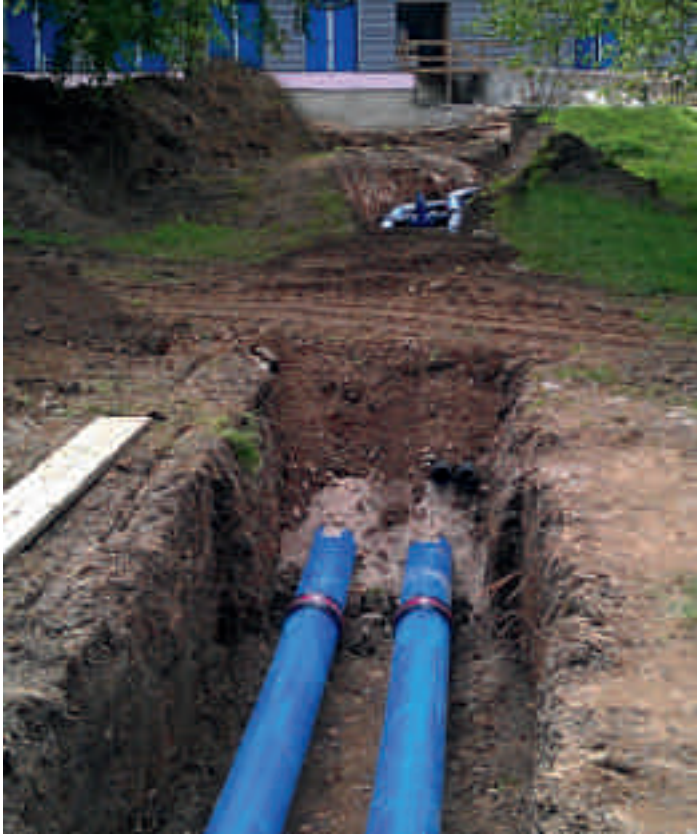
Bild 17.4: Rohwassersammelleitungen der Brunnen zum Wasserwerk Fig. 17.4: Raw water collection pipes from the tanks to the waterworks
