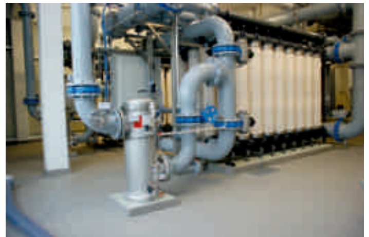
Bild 16.4: Ultrafiltrations-Straße Fig. 16.4: Ultrafiltration system
