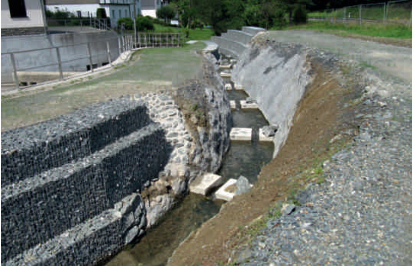
Bild 9.2: Fischaufstiegsanlage in der Brabecke am Fassungsbauwerk Brabecke Fig. 9.2: Fish migration facility in the Brabecke stream at the water retaining structure Brabecke
