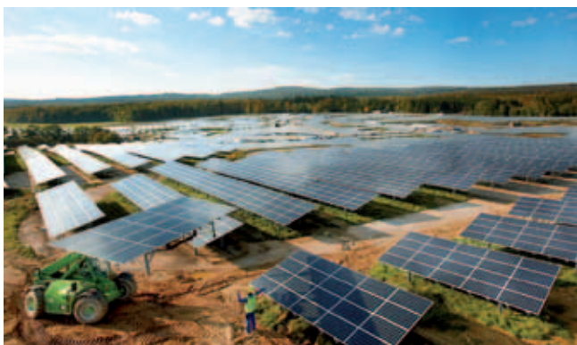
Solarpark Pferdsfeld 28,3 MW
