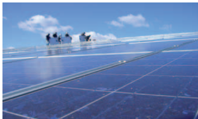
Großdachanlage auf einer Industriehalle 320 kW; Fläche ca. 2.500m 2
