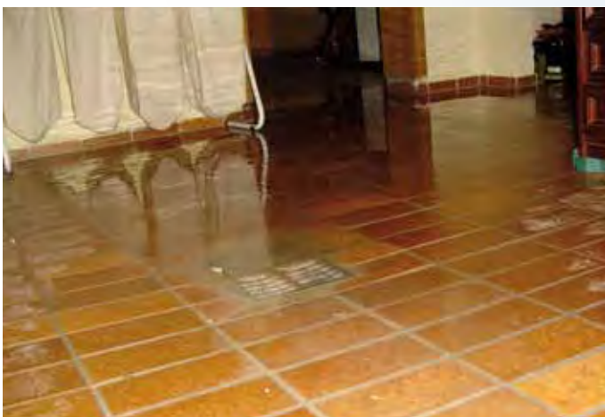
Abb. 2: Kellerüberflutung nach Grundwasseranstieg
