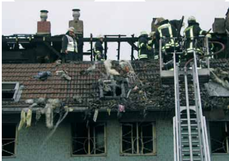
Nachdem der Brandrauch abgezogen ist, wird die Zerstörung der Flammen erst sichtbar.
